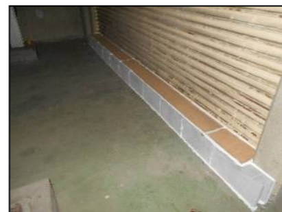
漏水防止防液堤
